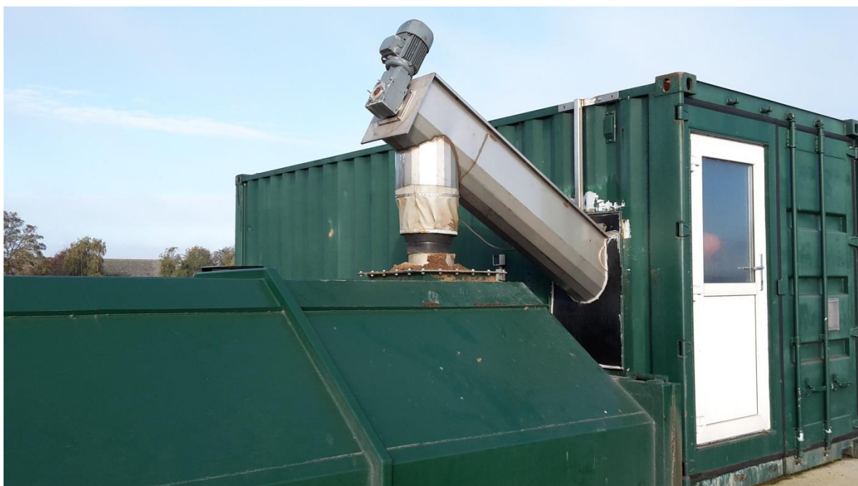
Figur 3. Fiberfraktionen blev overført fra separatoren til transportcontainer via en snegl. Overgangen til transportcontaineren er lukket med en gummimuffe.
